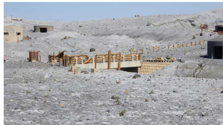
被害があった火の国橋
