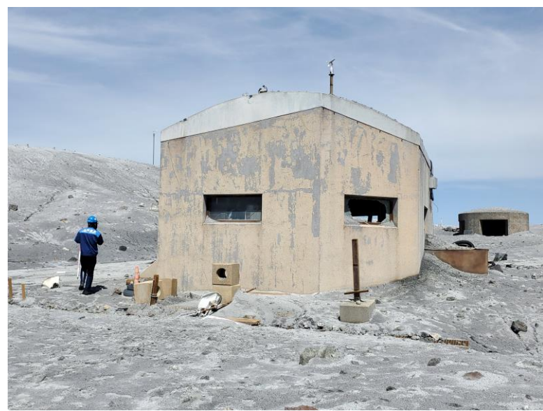
被害があった火口中央監視所
